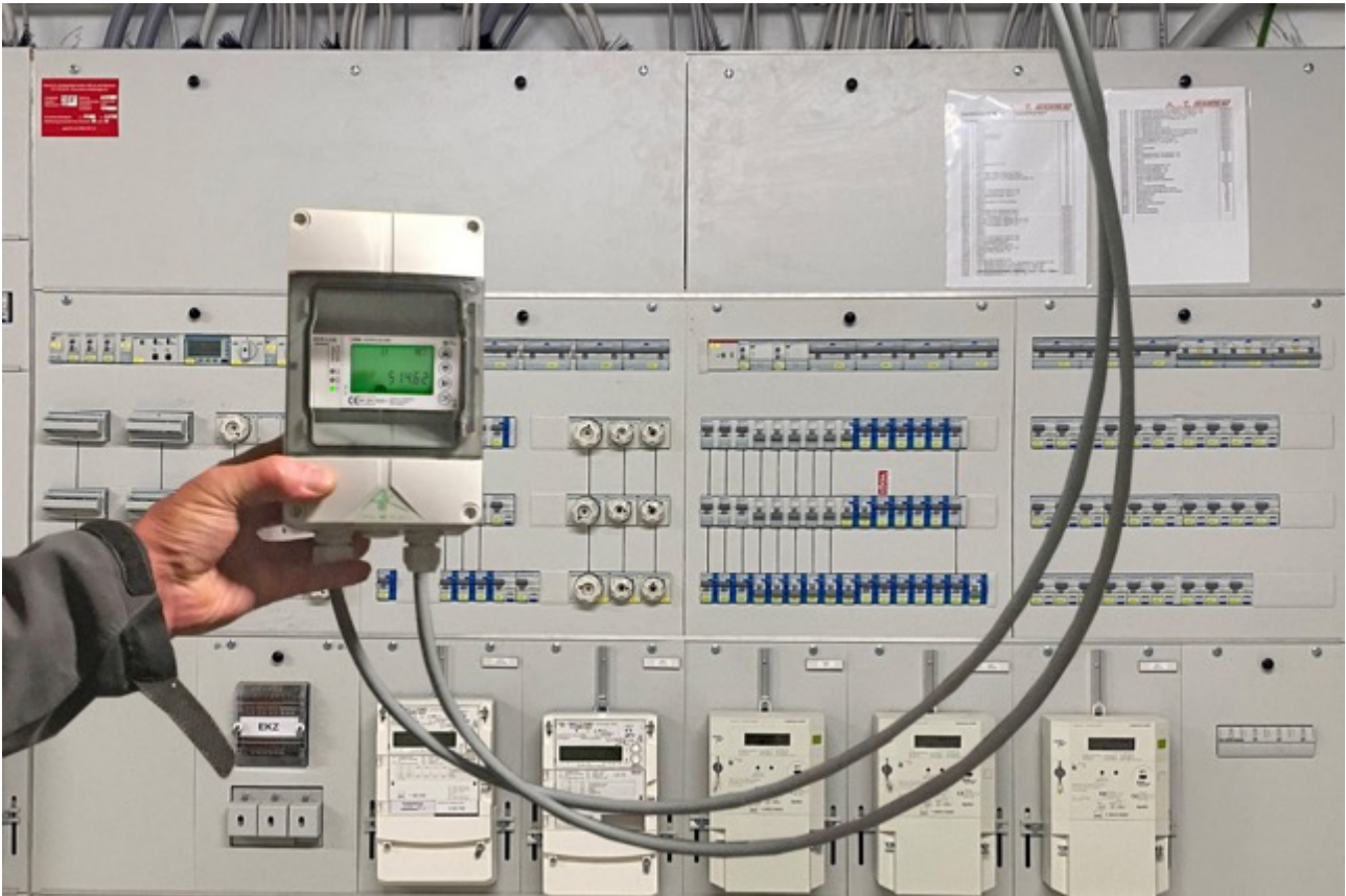
Elektroverteilung und installiertes Energie-Messgerät
