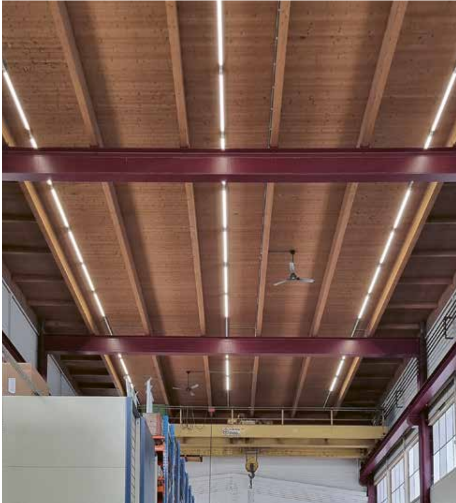
Die neu eingesetzten Lichtbänder bieten besseres Licht und verbrauchen deutlich weniger Strom als die alte Beleuchtung. (Bild: Nevalux AG)
