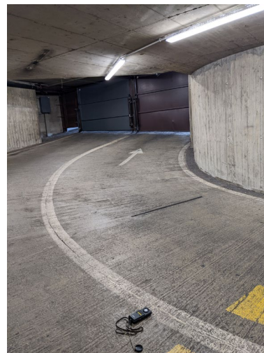
Réduction de 73% de l'intensité lumineuse dans les rampes d'accès.
