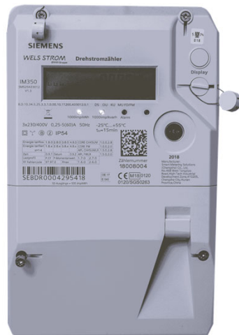
Fest installierter Zähler
