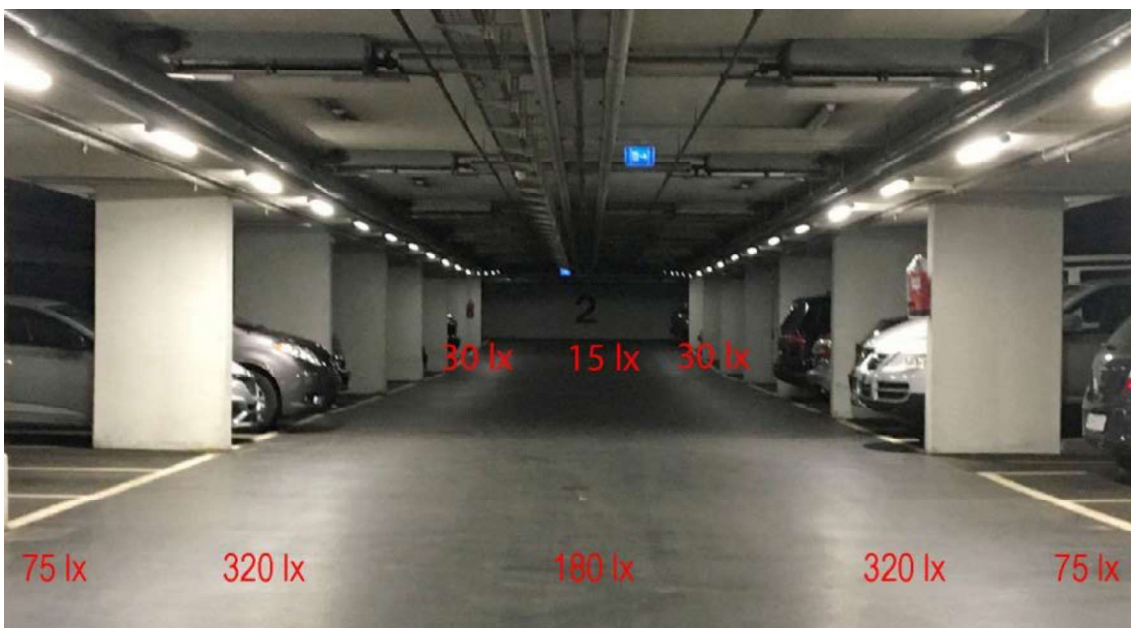
Figure 34 : Nouvel éclairage dans le garage Heuried (avec éclairage, lumière d'orientation à l'arrière)
